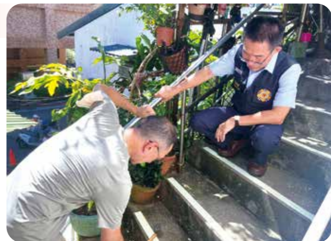
榮服處為方爺爺住處出入口階梯貼上防滑條，消除跌倒風險。(圖/臺北市榮服處)
