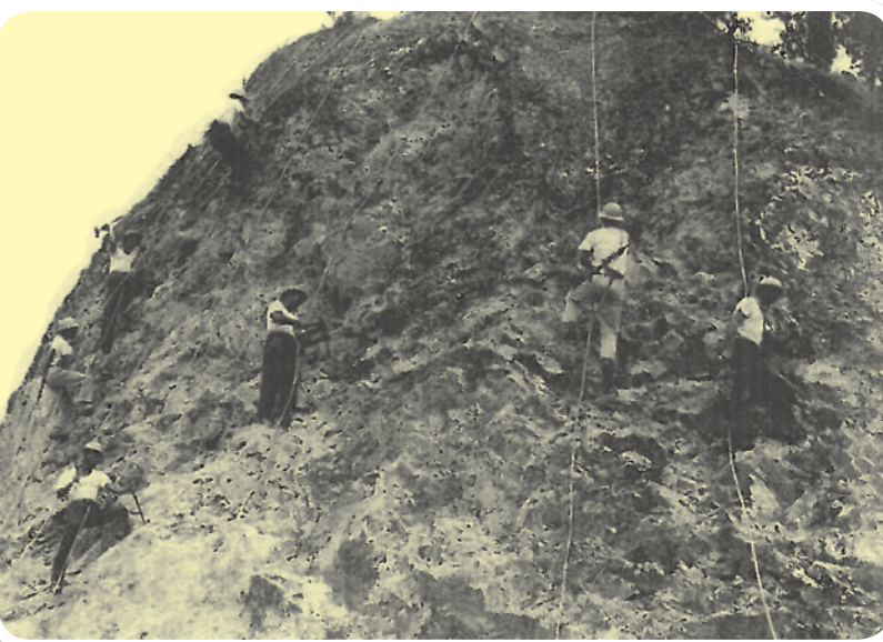
榮民員工以繩索繫身，攀附在岩石上辛苦施工。(圖片提供/榮民工程股份有限公司)
