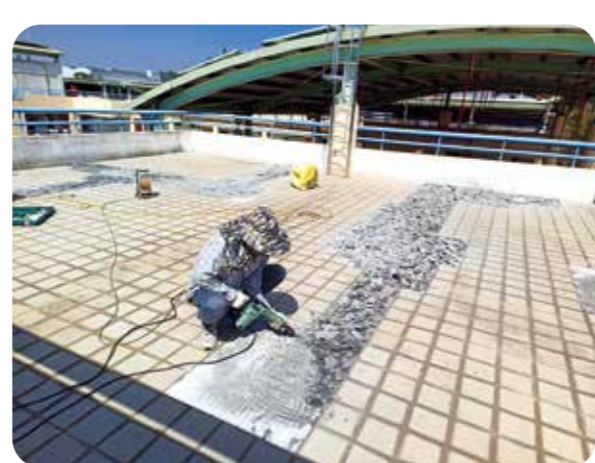
岡山榮家同仁用電動鋸開裂屋頂膨脹龜裂的磁磚及水泥層，重鋪水泥及刷塗防水層，完成修繕。(圖/岡山榮家)
